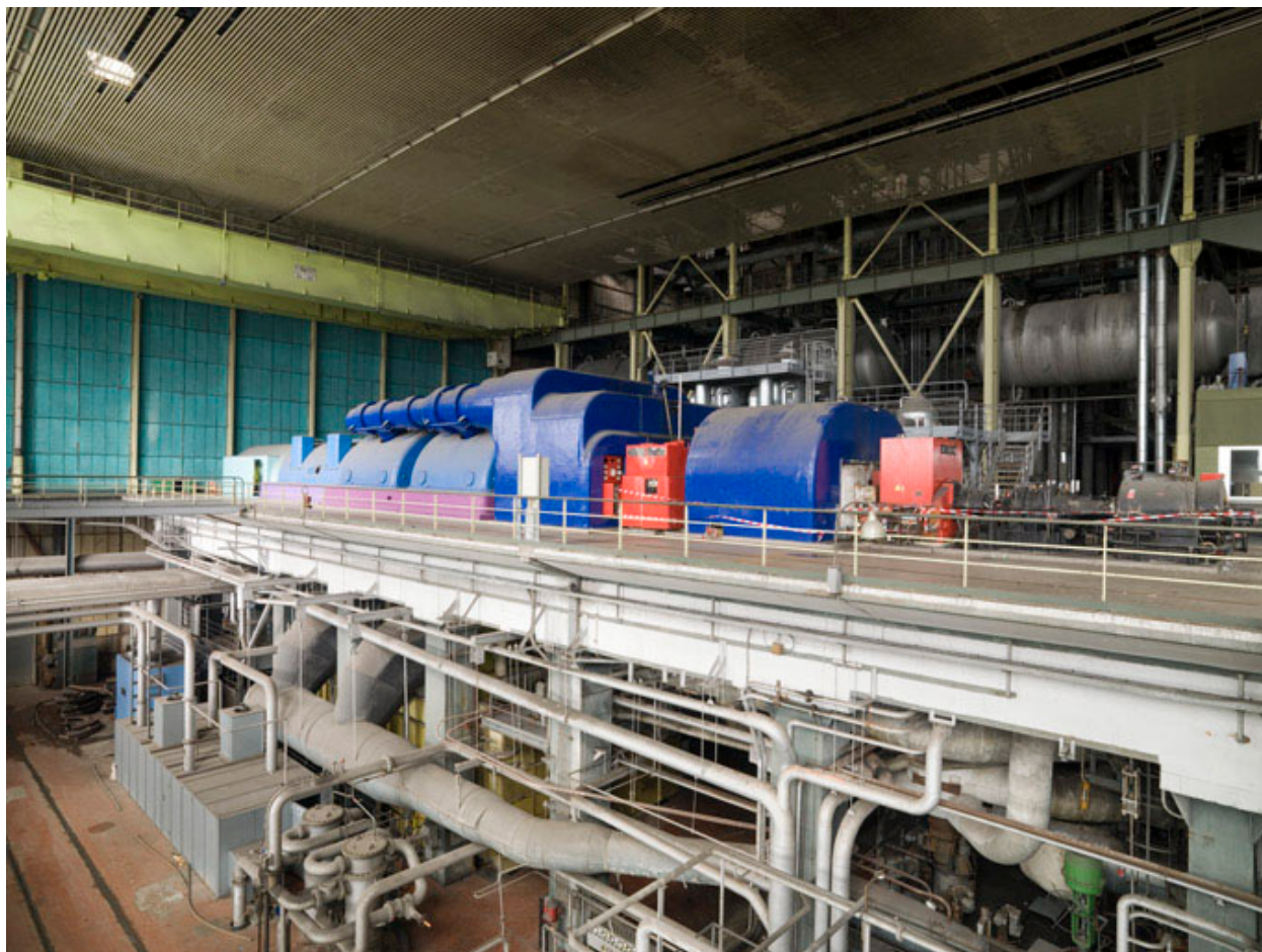
Poste d'eau. Pompe alimentaire principale.
