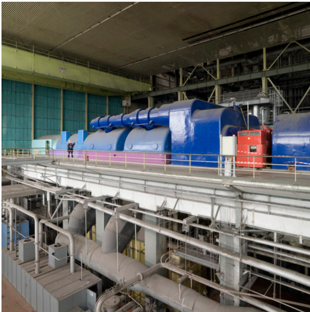
Poste d'eau. Pompe alimentaire principale.
