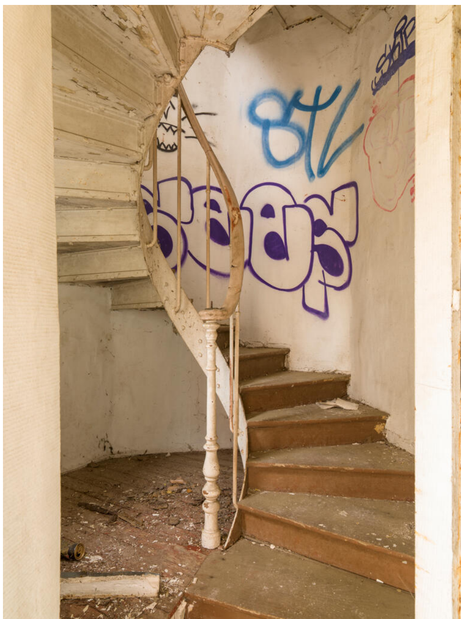
Maison d'Octave Allaire, départ de l'escalier reliant le premier et le second étage
