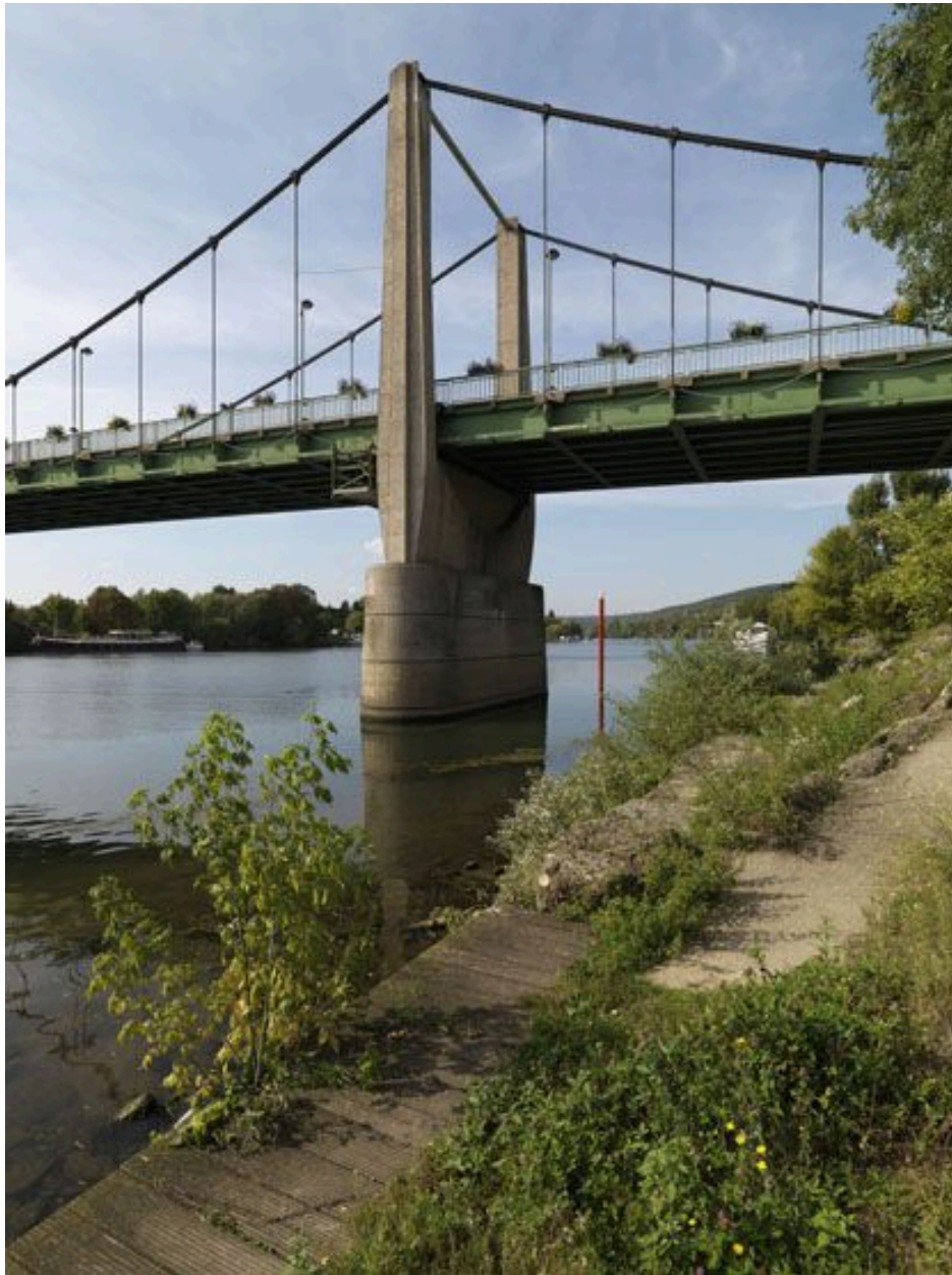
Vue de la première pile du pont et du dispositif de suspension depuis les quais vers l'aval.
