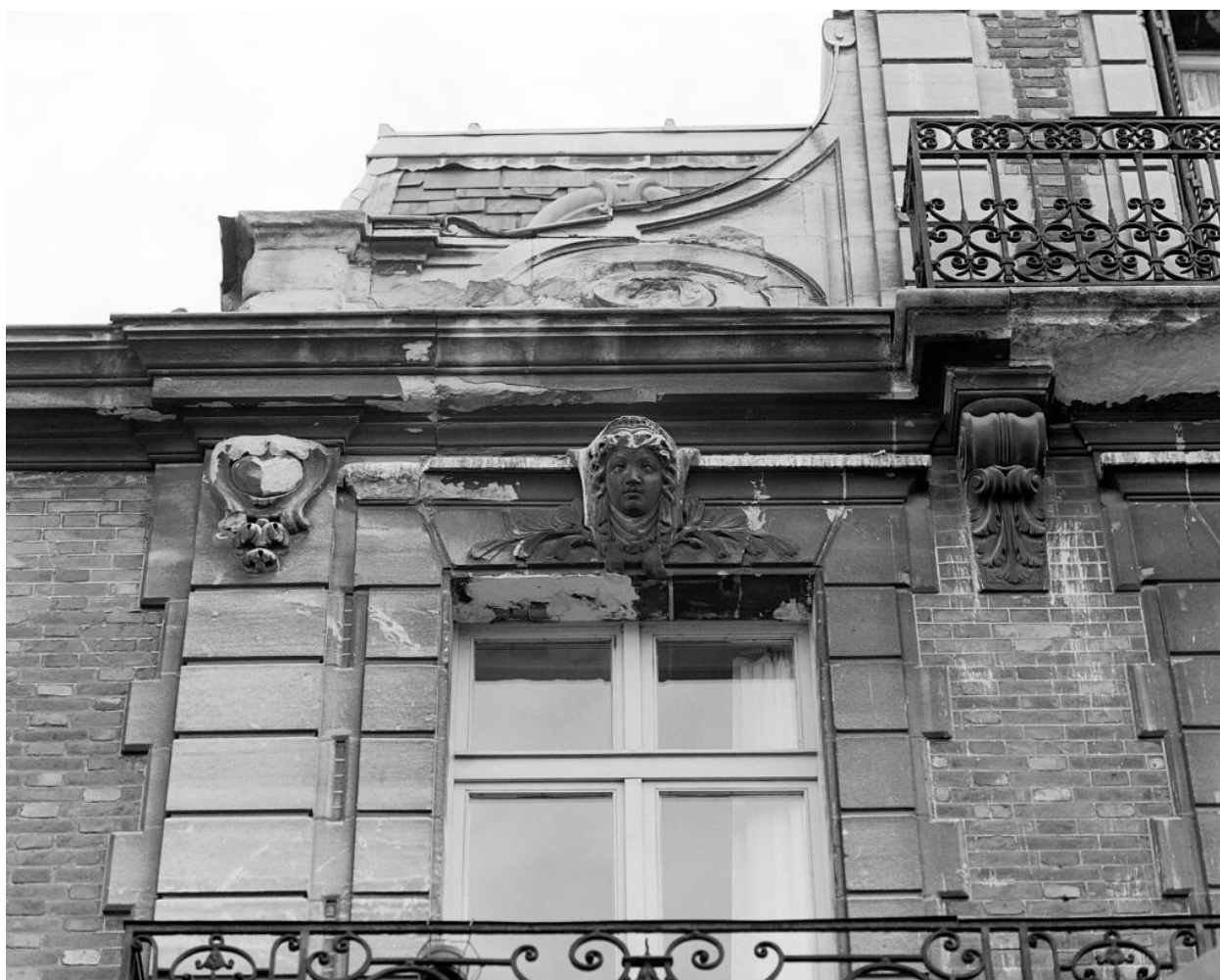
Détail de l'encadrement de fenêtre au 1e étage. Maison d'Antonin Raynaud, puis maison de la Résidence Sociale
