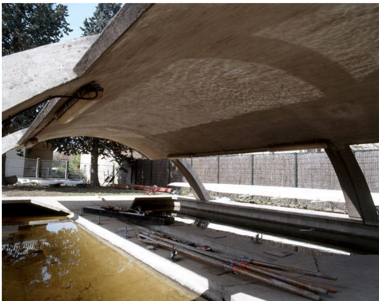
Le tank à ramer : détail de la coque.
