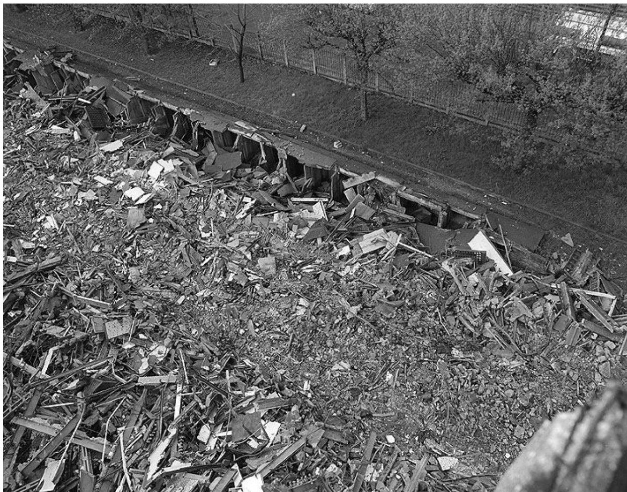
Galerie technique entre P1 et la Chaufferie. Campagne photographique, lors de la destruction du bâtiment en 1976.
