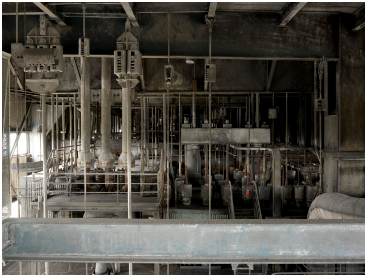
Générateur de vapeur 250 MW. Chaudière
