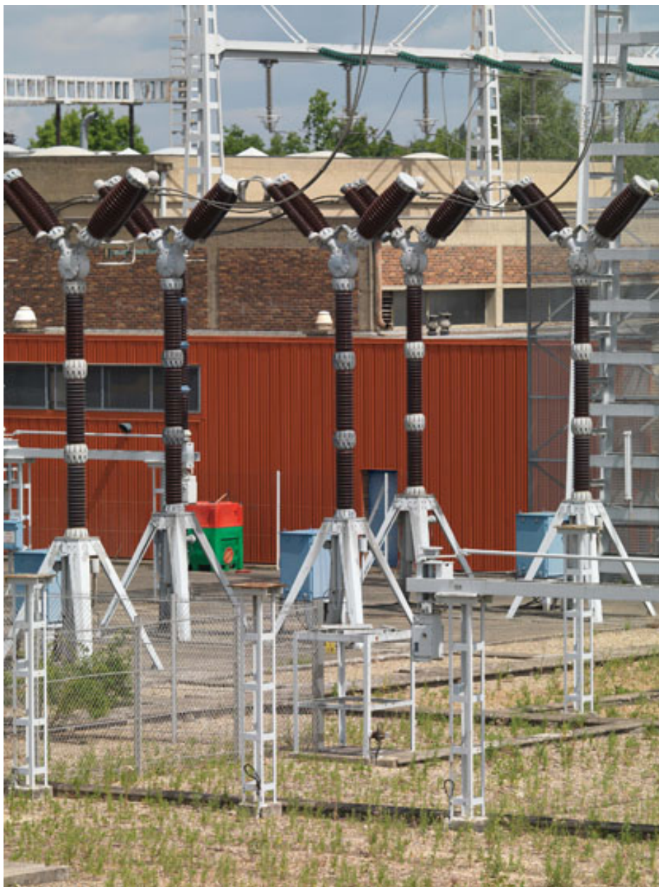
Poste de transformation. Détail.
