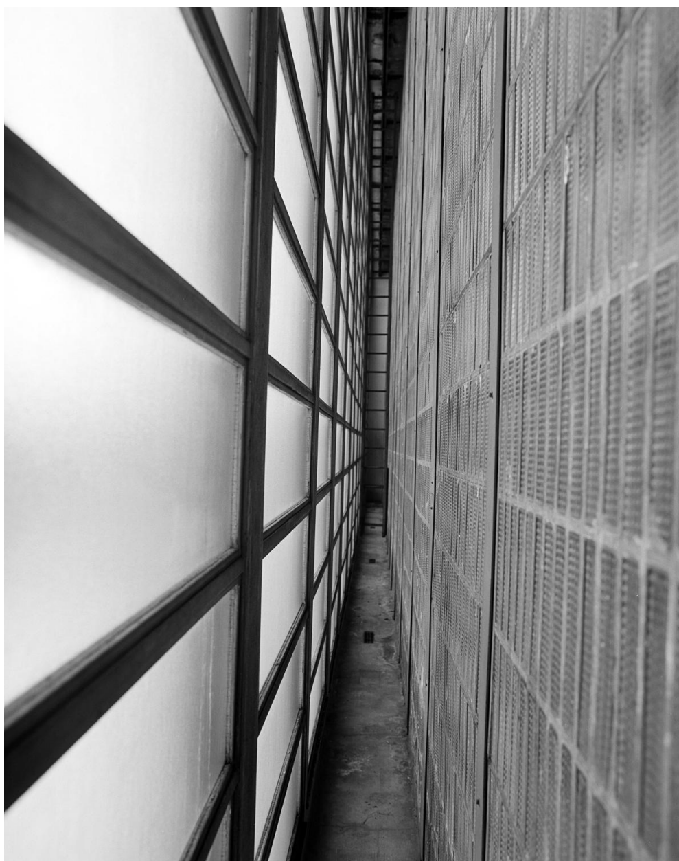
Piscine. Vue prise entre les parois, extérieure (à gauche) et intérieure (à droite), de la façade. Ecole maternelle, école primaire de garçons, école primaire de filles dites groupe scolaire Marius Jacotot
