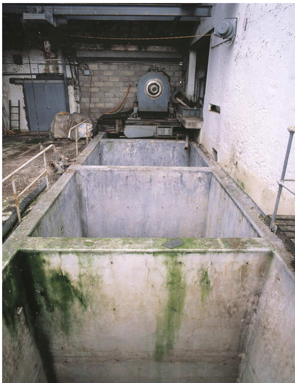
Bâtiment C, détail des cuves.
