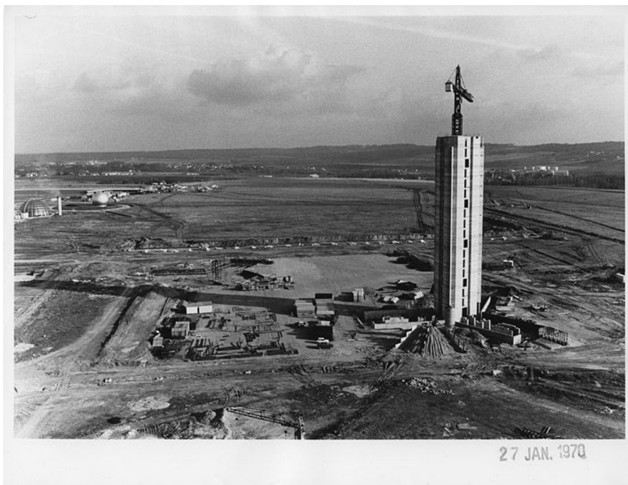
Chantier de construction d'une des tours de Meaux-Beauval. Vue du noyau avec la grue intérieure . 27 janvier 1970. (OPAC Meaux)
