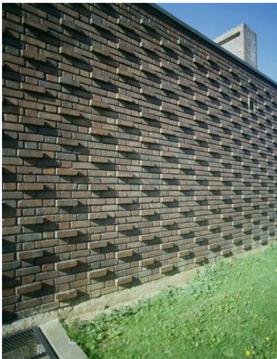
La façade sur rue : détail de la mise en oeuvre des briques.
