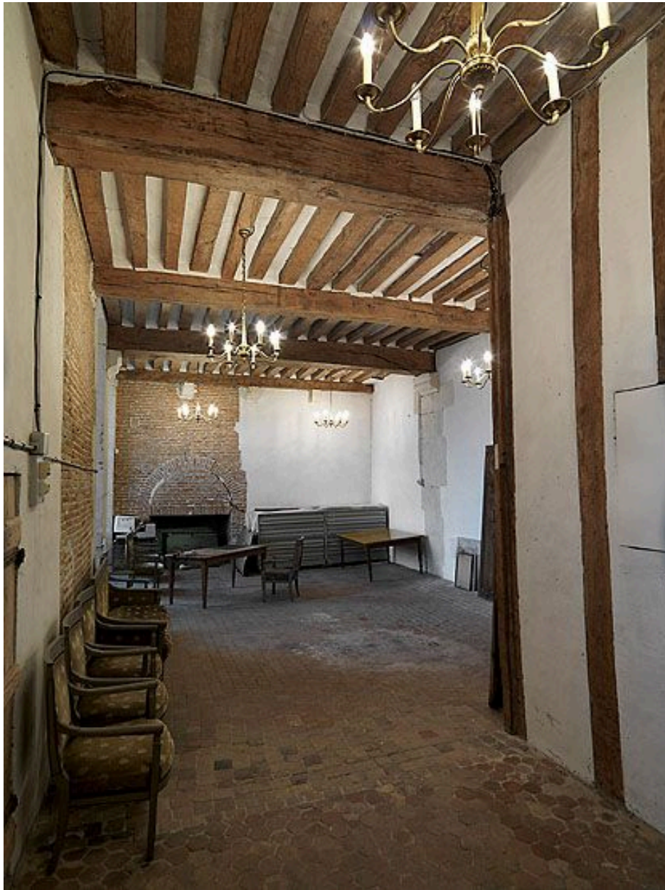
La salle en haut de l'escalier principal : vue intérieure, prise depuis le nord.
