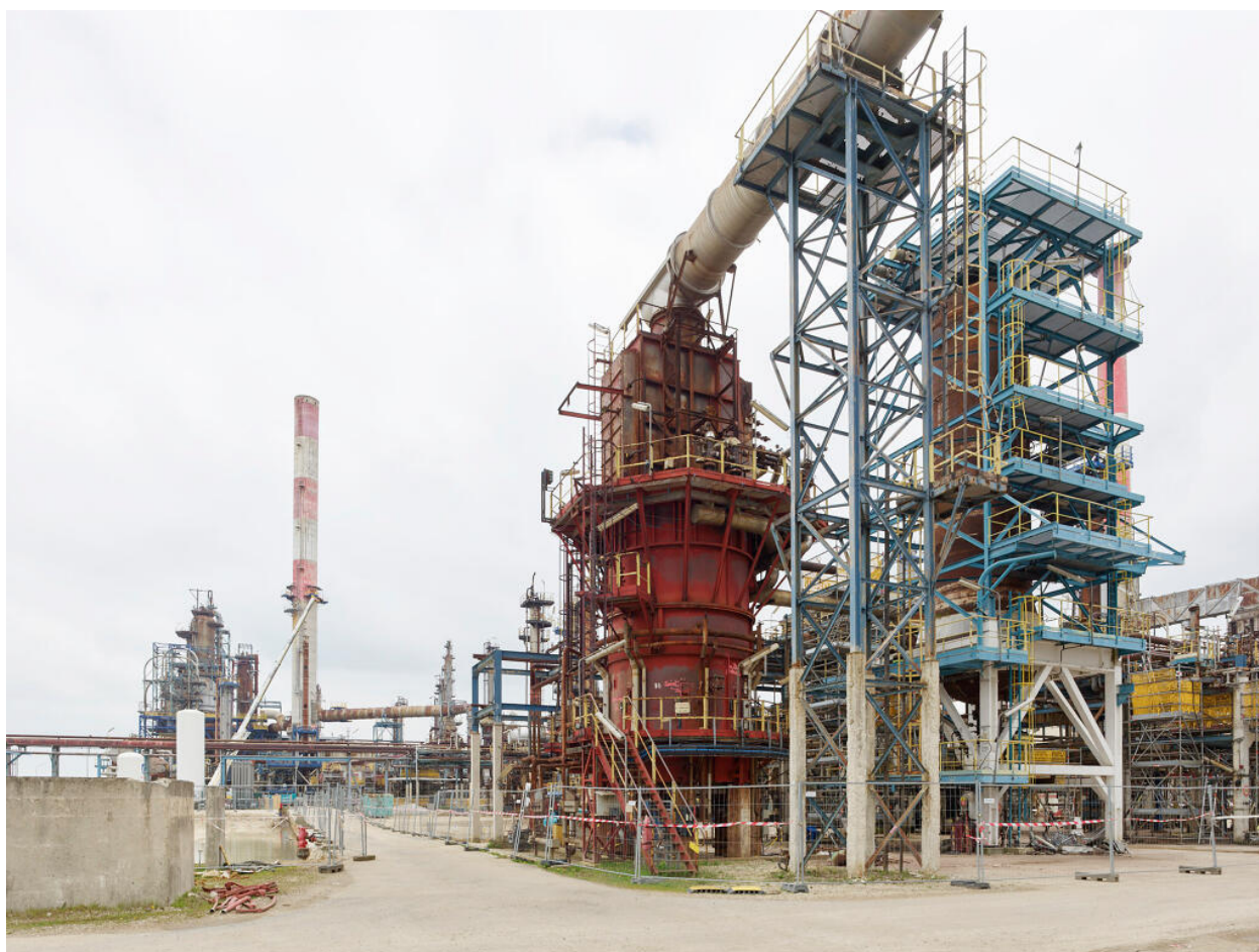
Unités Ouest. Four et réacteur des unités 662 F1001 et 662 D1001 d'hydrodésulfuration des gazoles. Au fond , les unités Est.
