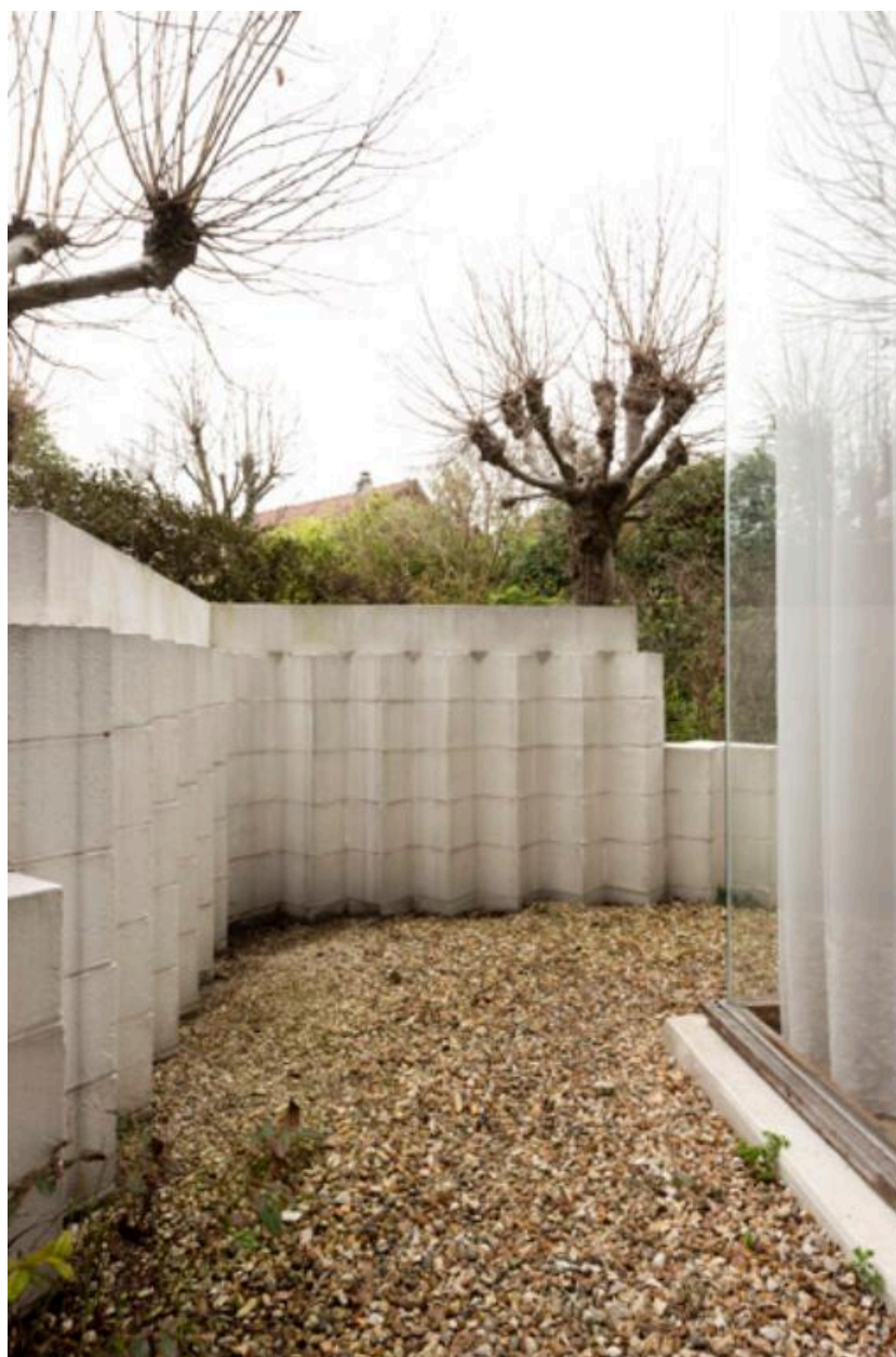
Vue du mur de clôture réalisé en bossage de parpaings de béton Siporex.
