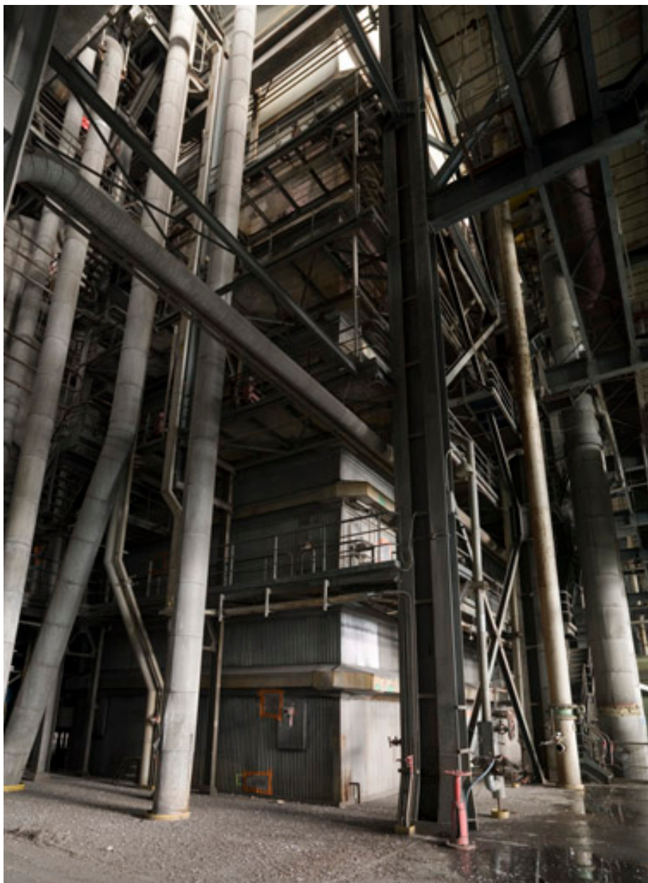
Générateur de vapeur 250 MW.
