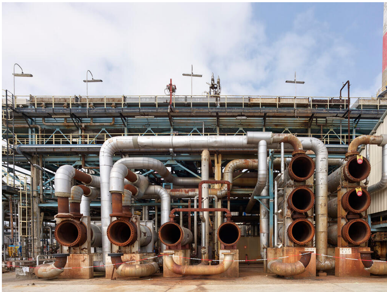
Unités Ouest - Unité 642 Reforming catalytique. Vue d'ensemble des échangeurs à faisceaux tubulaires de l'unité.
