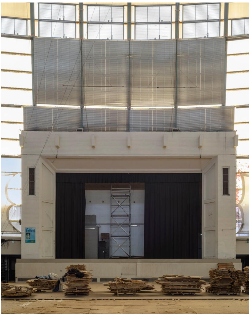
Grande Nef Lucien Belloni, dite Grande Nef de l'Île-des-Vannes avant travaux. Détail de la scène.
