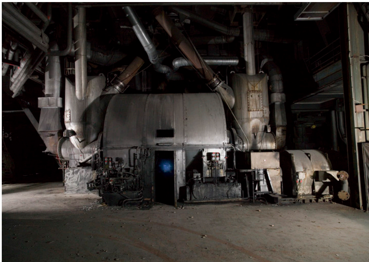
Générateur de vapeur 250 MW. Broyeur.
