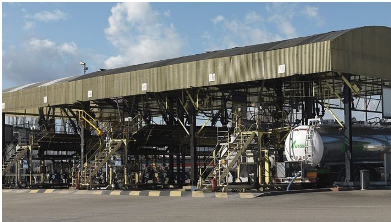
Villeneuve-le-Roi, dépôt pétrolier. Détail du quai de chargement des camions.
