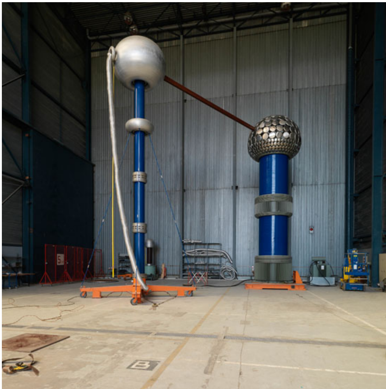
Intérieur du Hall d'essais synthétiques. Matériel d'essais.
