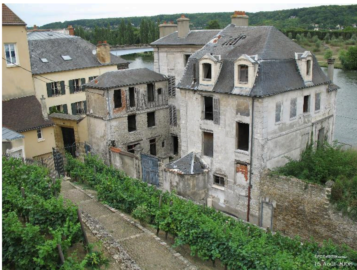
Vue du mauvais état de l'hôtel en 2008.
