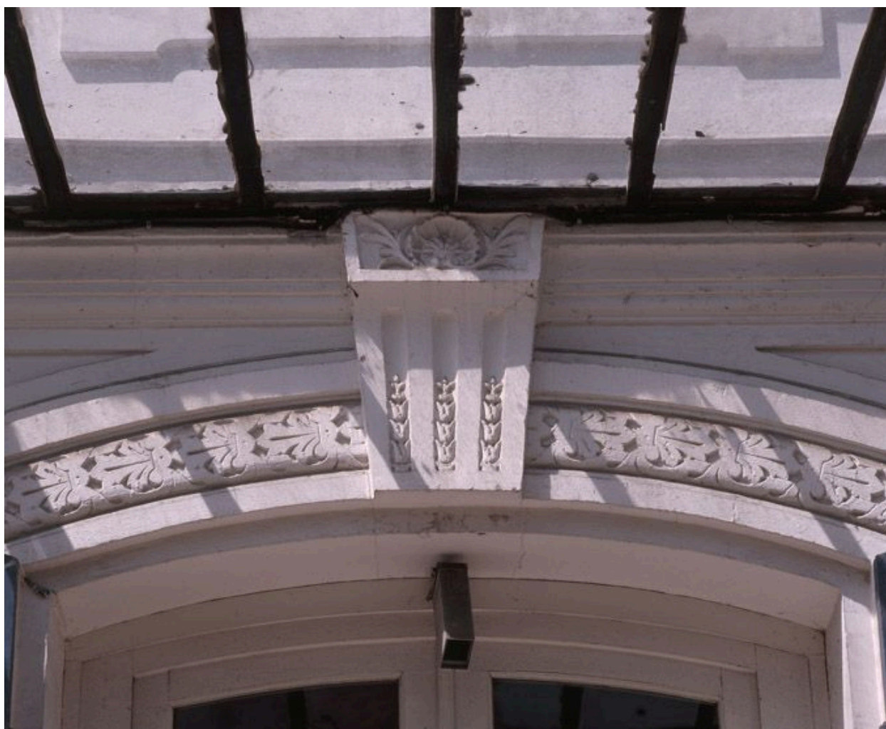
Détail de l'agrafe de la corniche cintrée en archivolte sur l'extrados de l'arc de la porte d'entrée.
