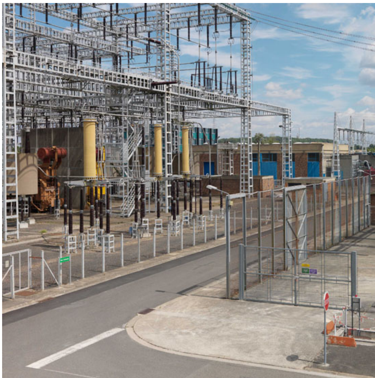
Charpente électrique extérieure. Détail.
