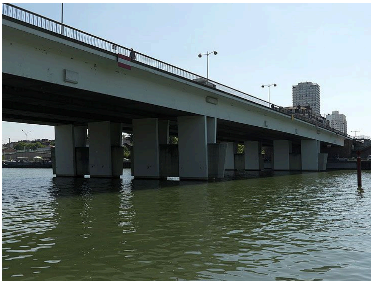
Choisy-le-Roi. Pont de Choisy (n°2). Vue d'ensemble depuis la berge de la rive droite.
