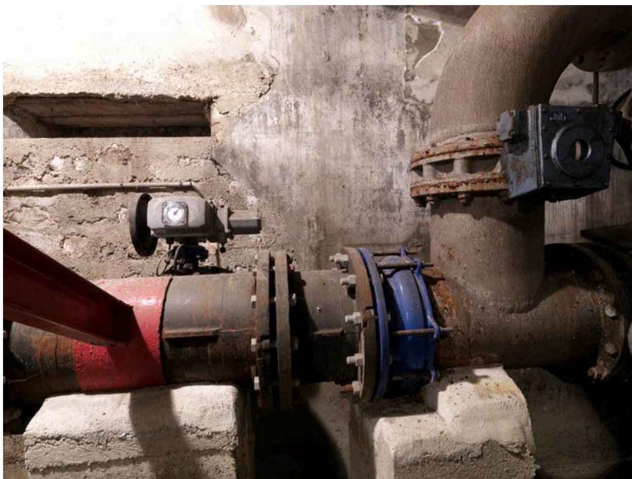
Conduite de refoulement et anti-bélier.
