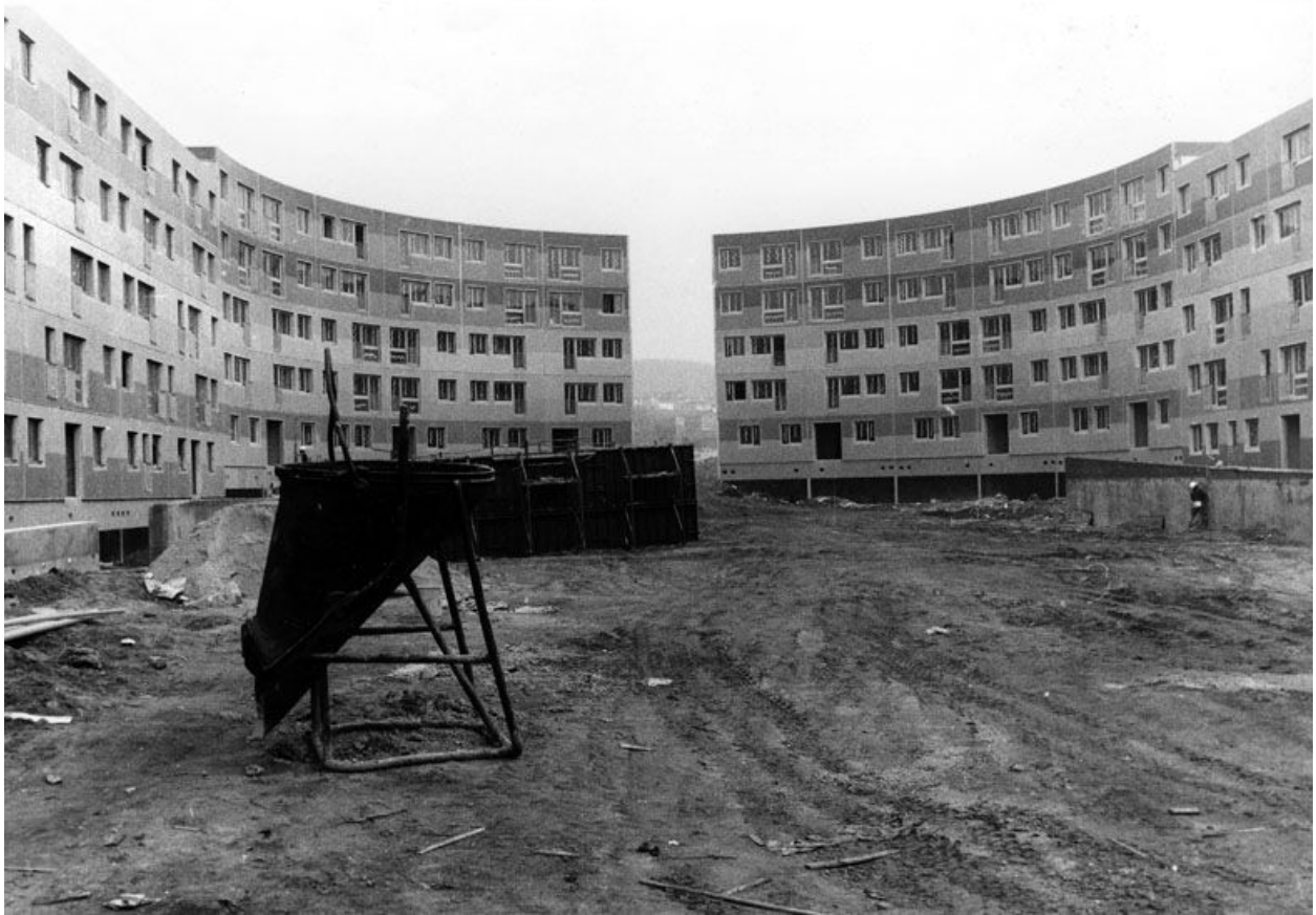
La Noé. Photographie du chantier prise le 17 avril 1973, au niveau de la future place de l'Hippodrome. (Mairie de Chanteloup-les-Vignes).
