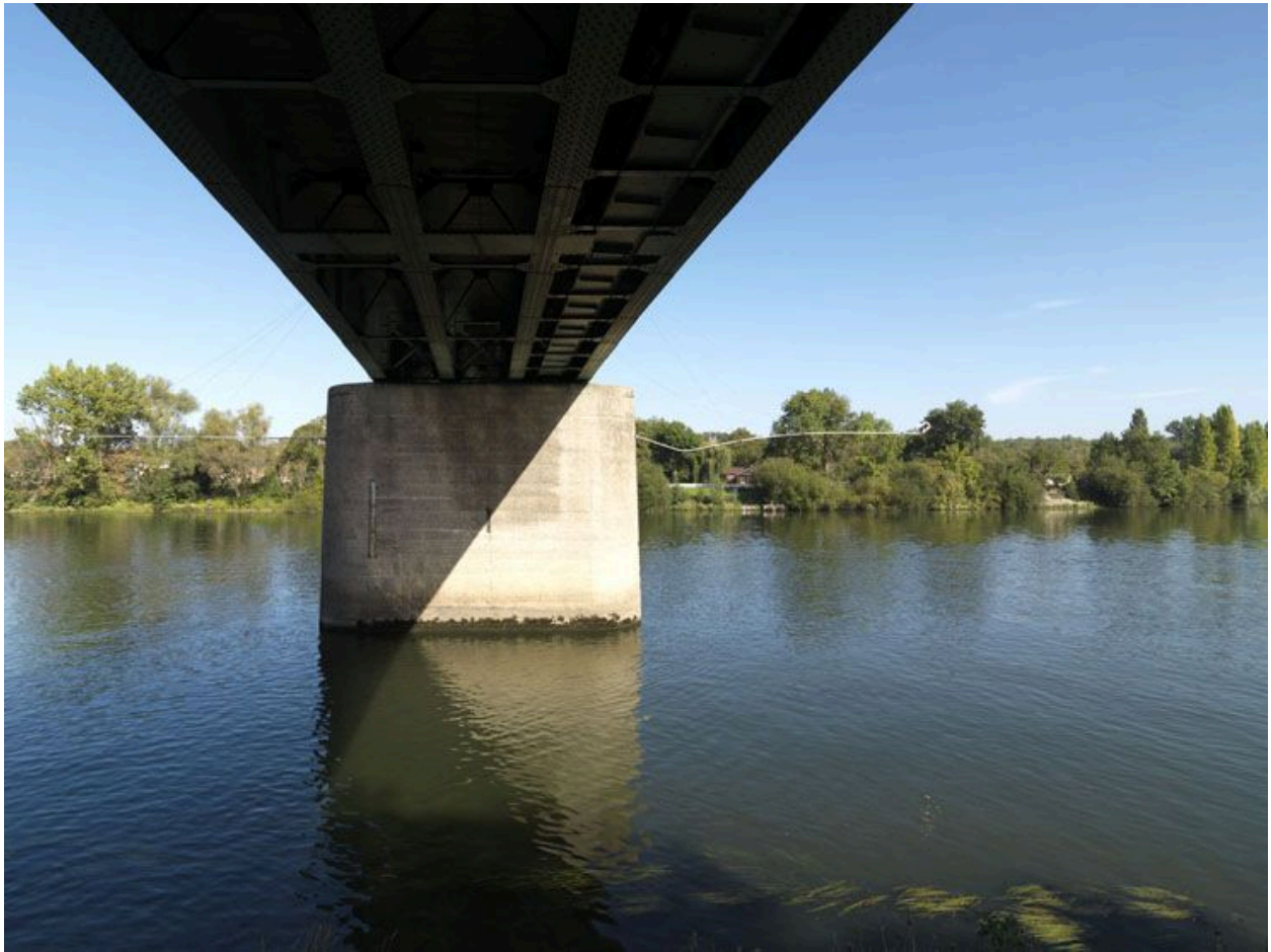
Poutres métalliques du tablier et pile en éperon vus depuis les quais.
