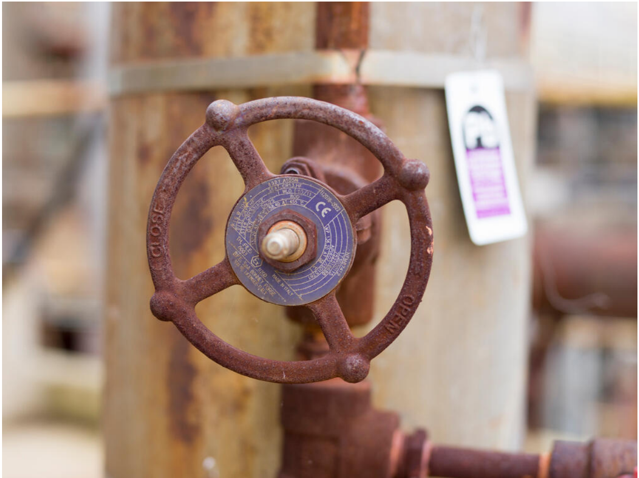
Volant de vanne d'un circuit de fluidisation.
