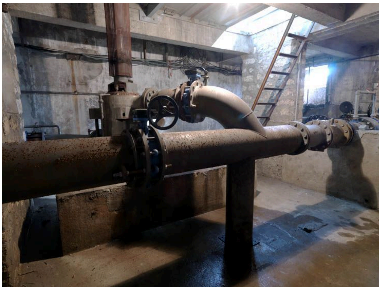
Turbine et conduite de refoulement.
