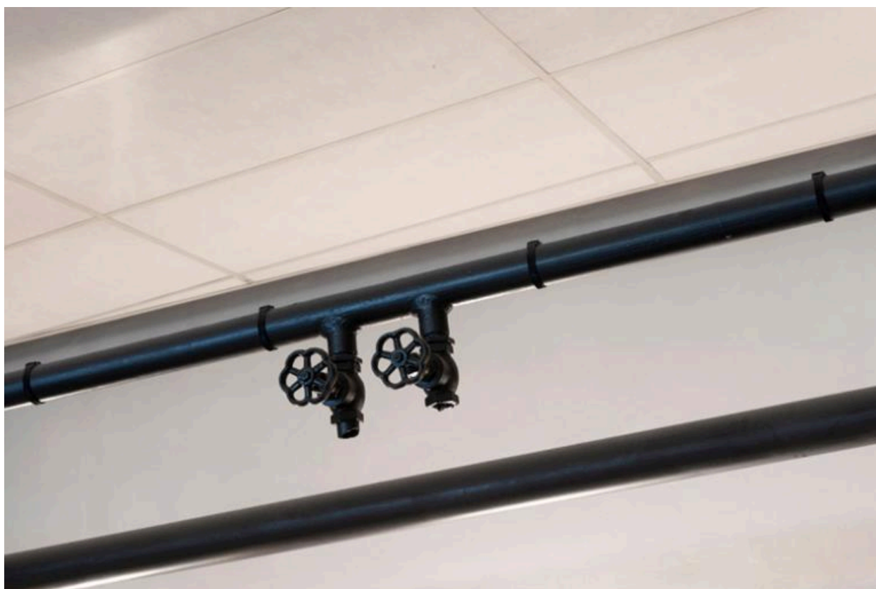
Détail des canalisations apportant l'eau chaude et l'eau froide dans les douches.
