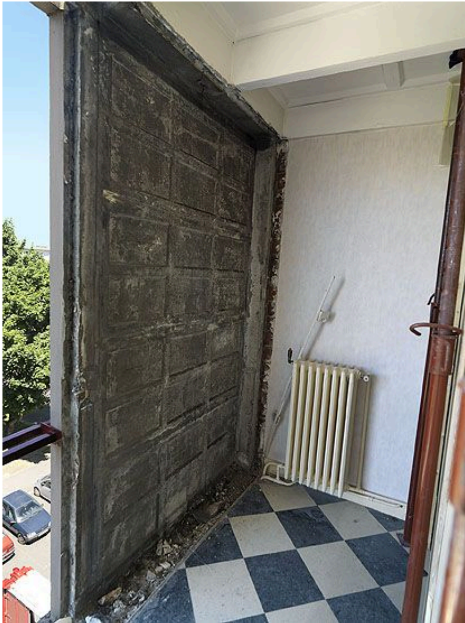
Vue générale des murs de béton ayant reçu des graffiti.
