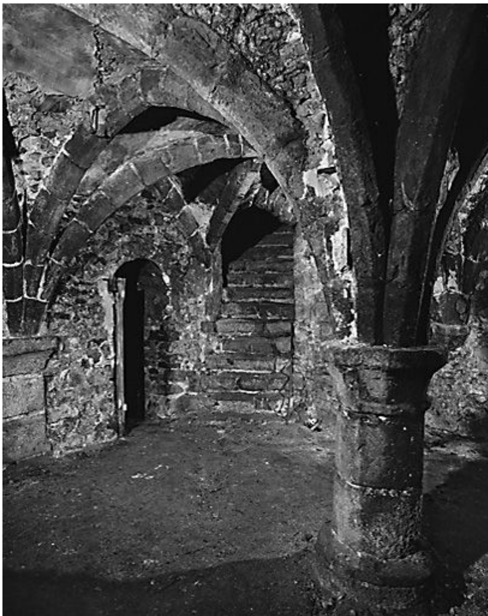
Vue du premier niveau de cave, depuis l'ouest : pilier central et départ de l'escalier conduisant au rez-de-chaussée.
