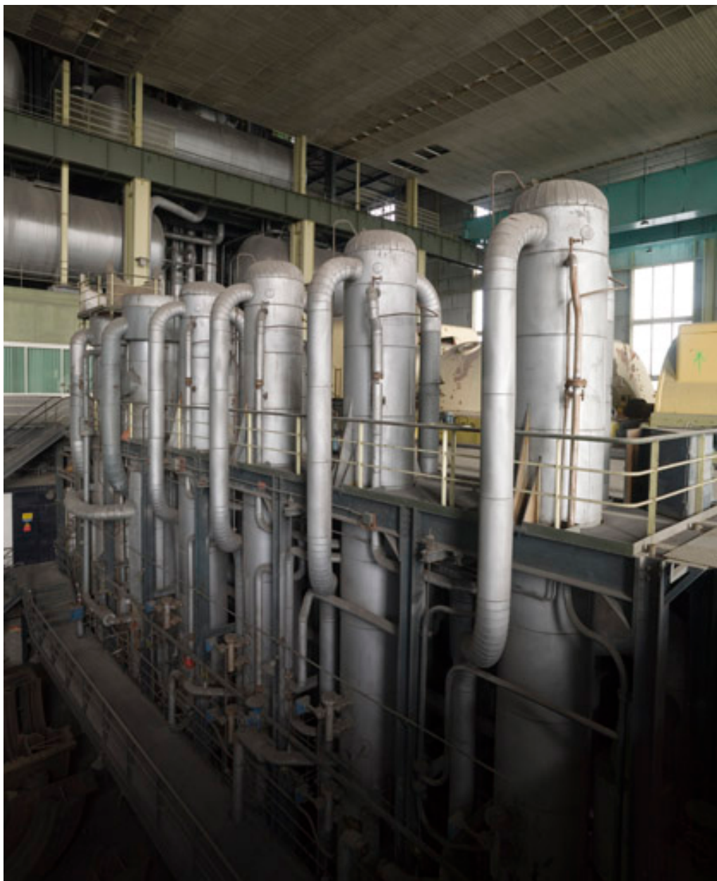
Poste d'eau tranche 125 MW. Turbines
