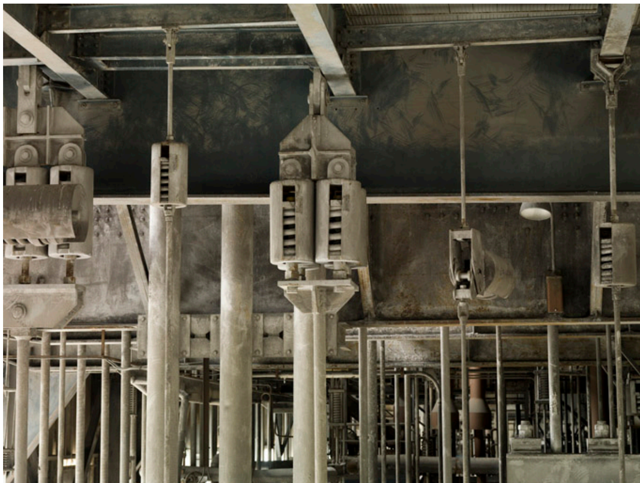
Générateur de vapeur 250 MW. Chaudière.
