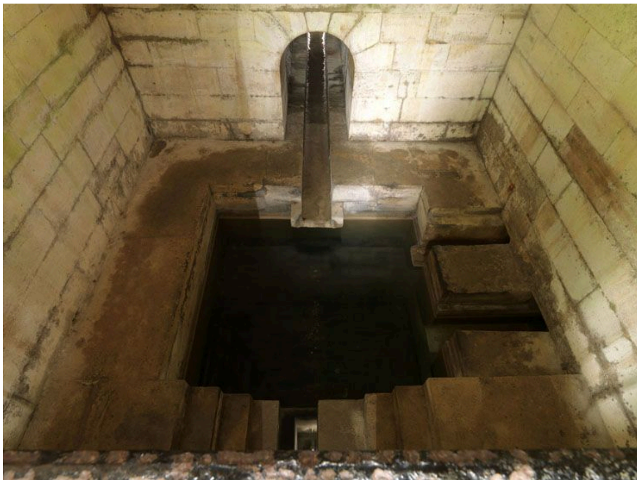
Rungis, Ecoliers (passage des). Intérieur du regard I : vue sur le bassin et les départs de galeries.
