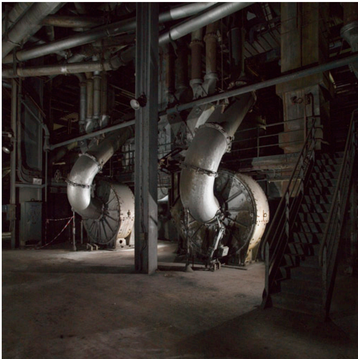
Générateur de vapeur groupe 125MW. Broyeur.
