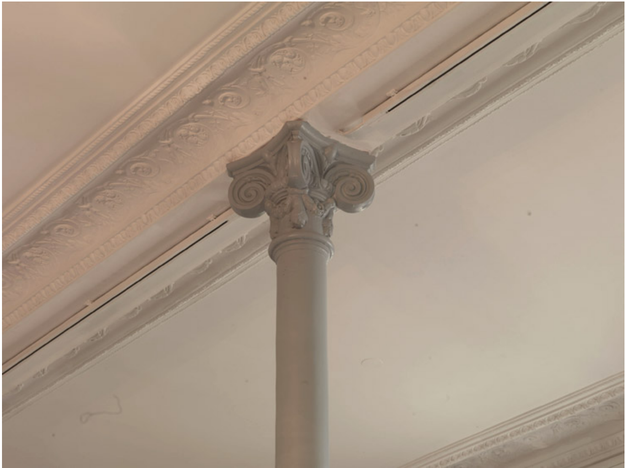
Détail du chapiteau ionique à cornes d'une des colonnettes de fonte soutenant la galerie.
