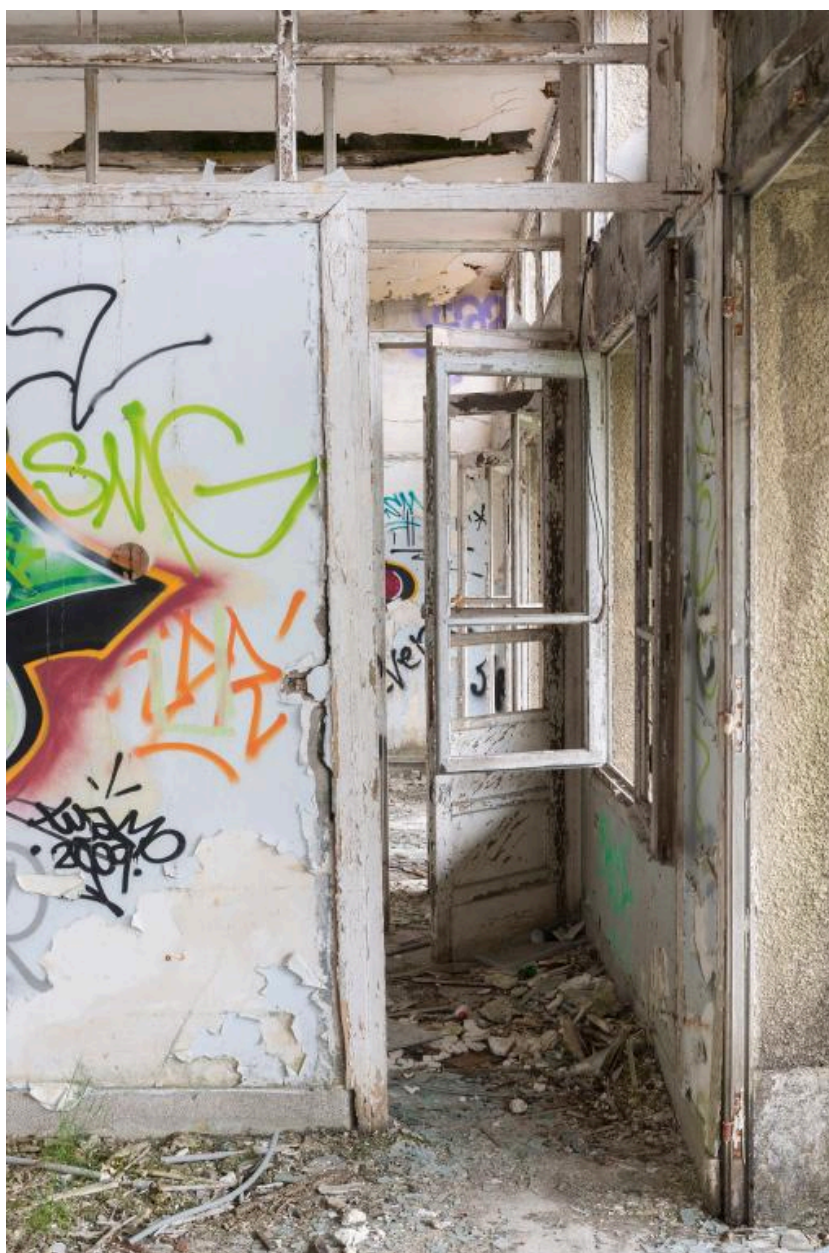
pavillon Bonnefoy-Sibour, enfilade entre plusieurs locaux techniques
