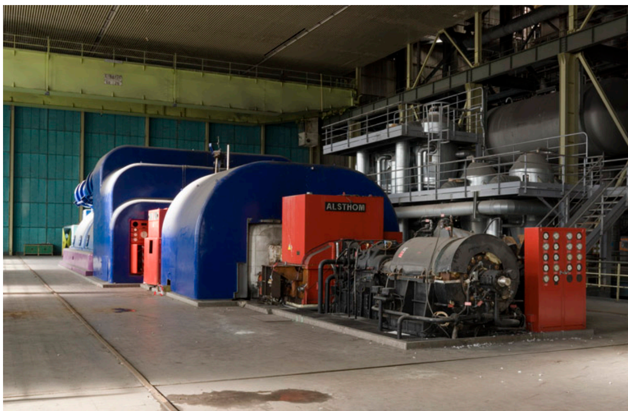
Poste d'eau. Pompe alimentaire principale.
