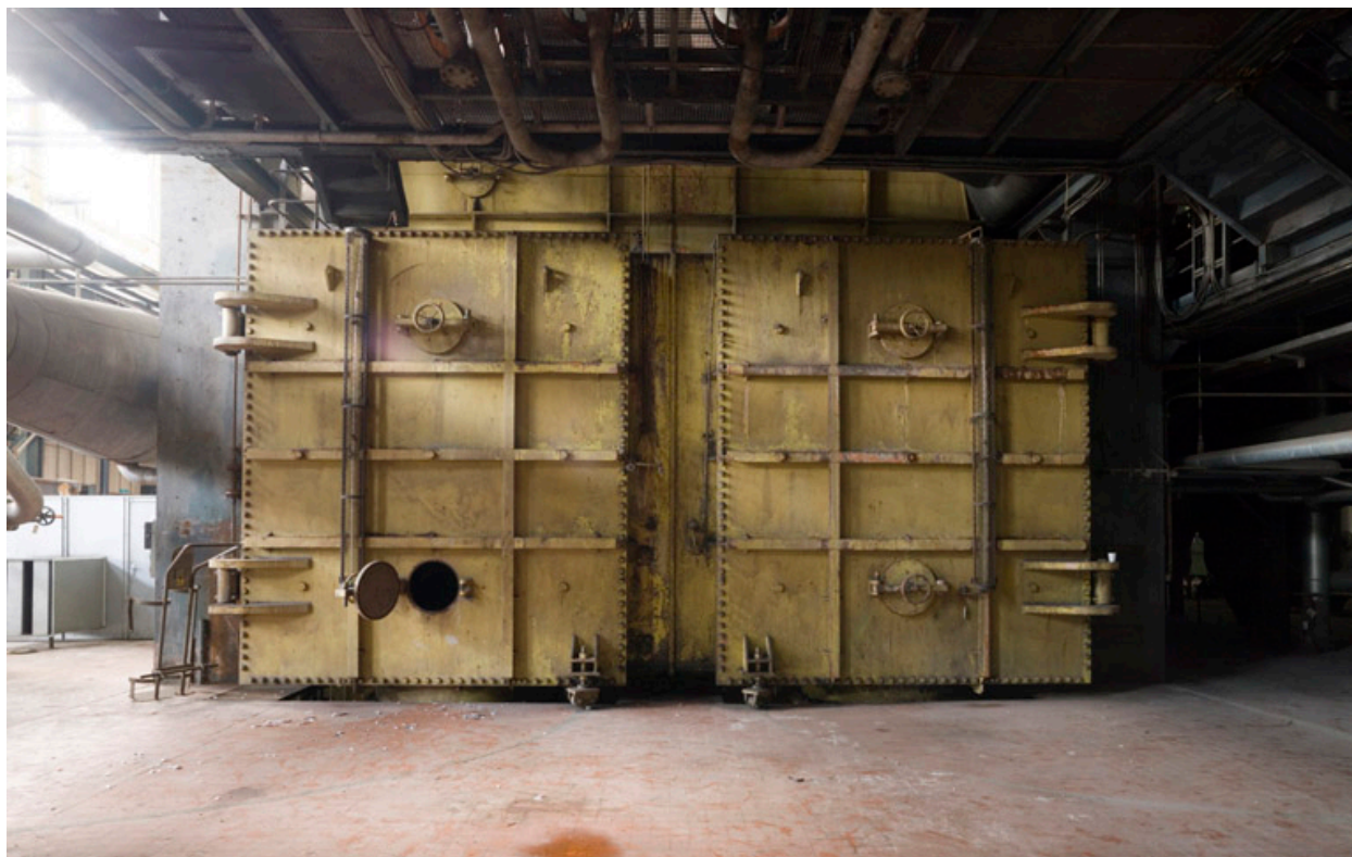
Condenseur de la tranche 250 MW.
