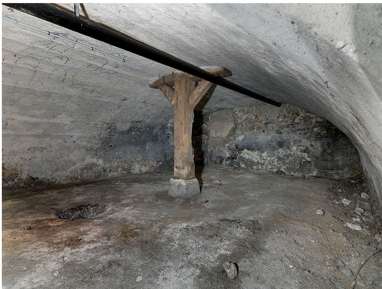
Aile sud de l'ancien séminaire : vue d'un des berceaux de cave, avec renfort en bois.
