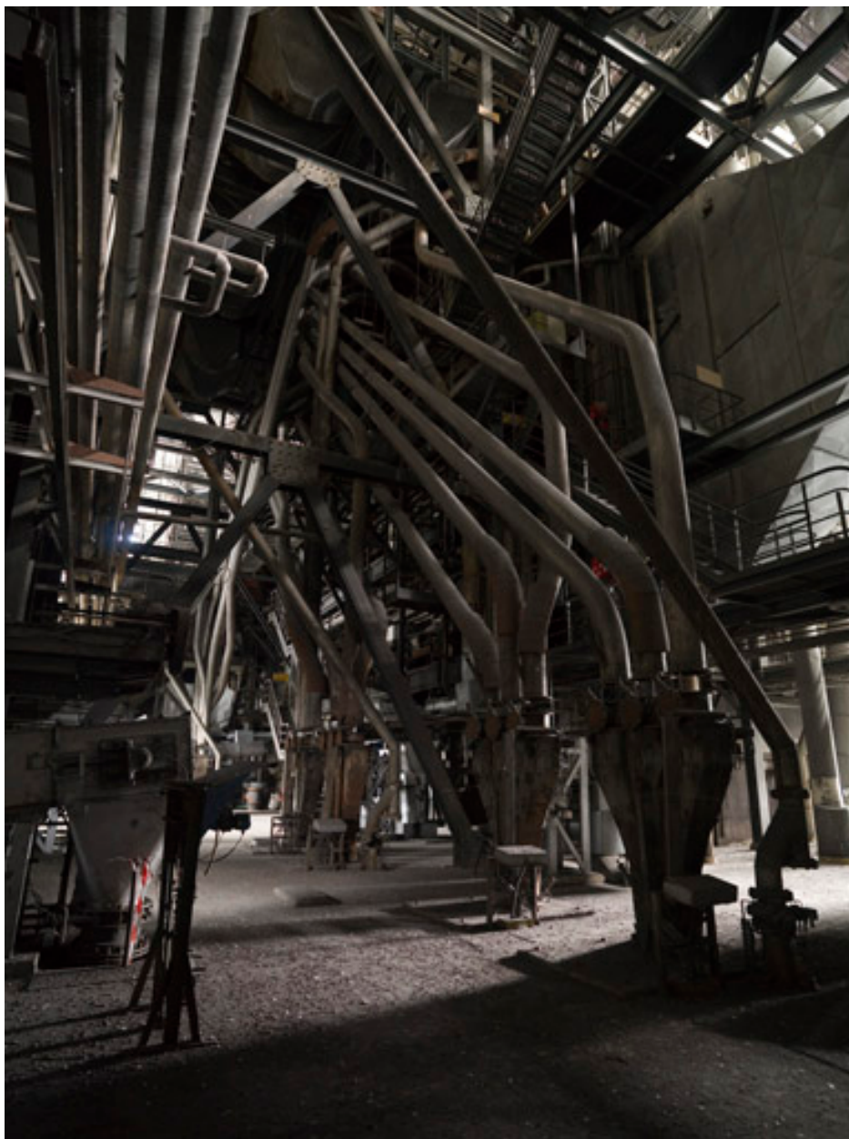
Générateur de vapeur groupe 125MW. Broyeur.
