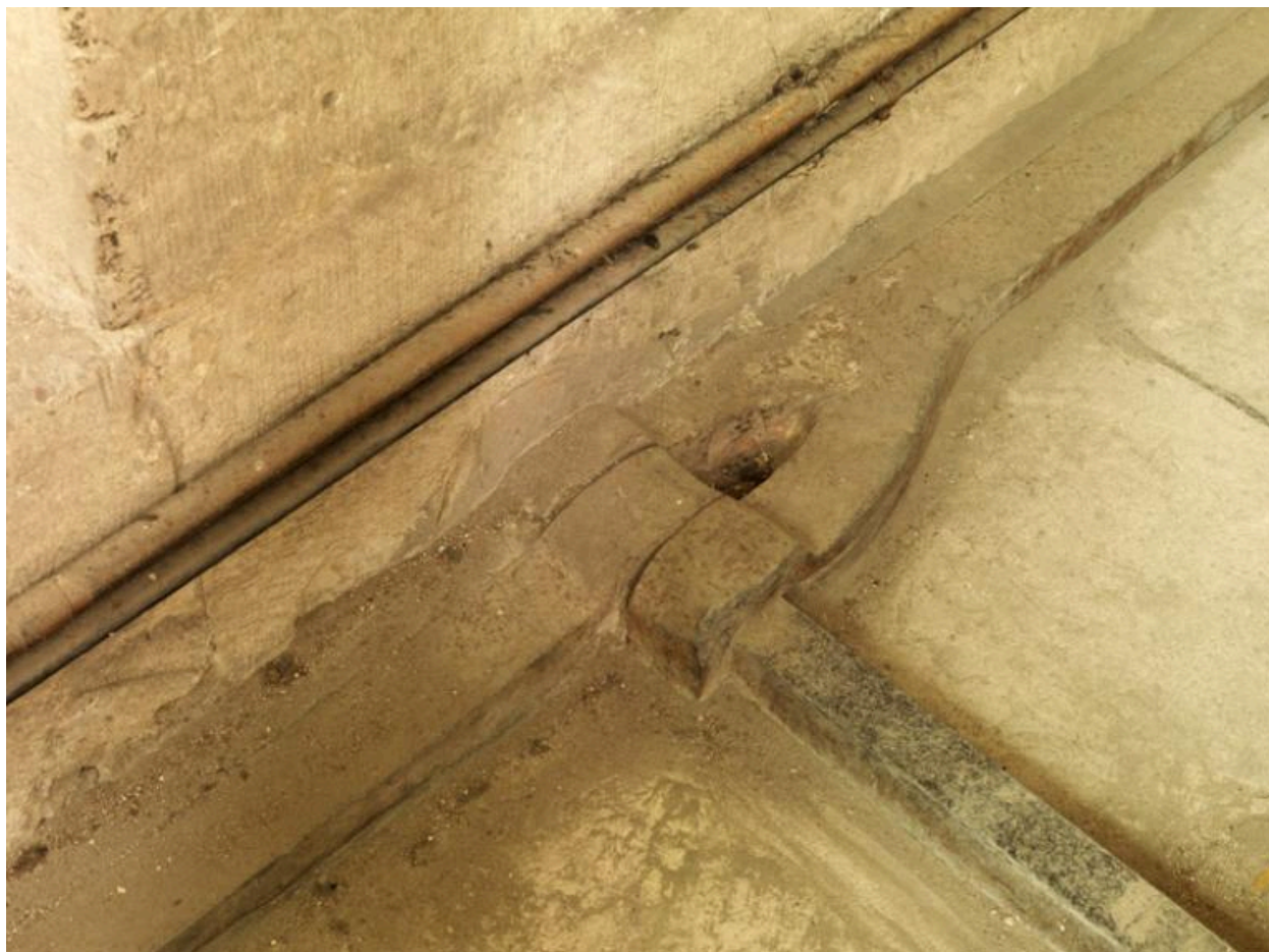
Tirant de fer au sol.
