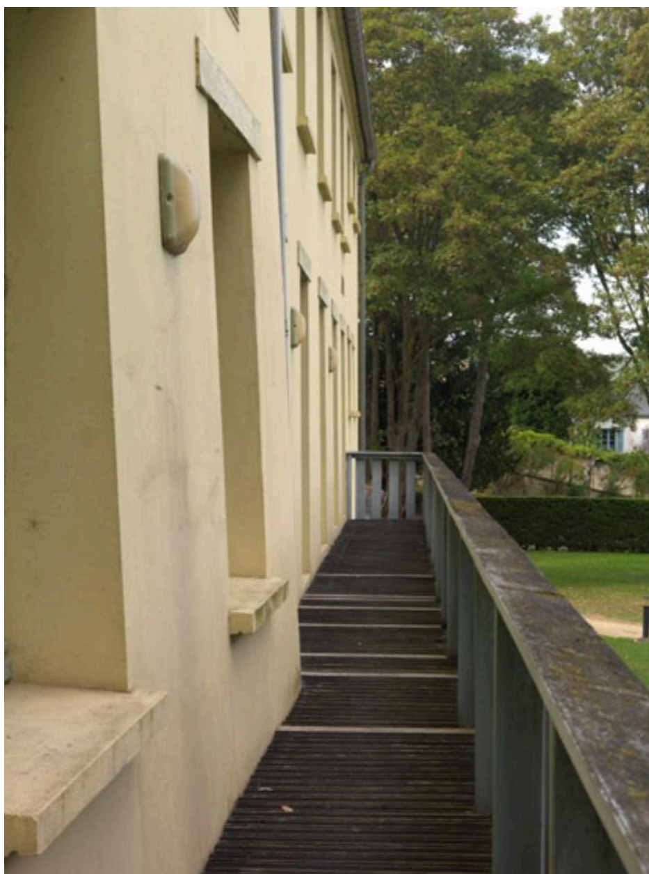
Coursive du premier étage montrant la déclivité du mur de façade.
