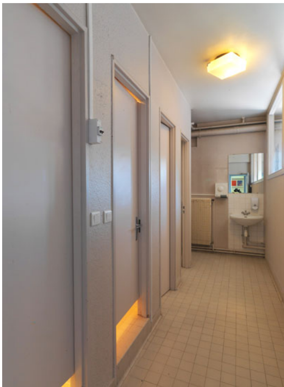
Un bloc de sanitaires (1er étage).
