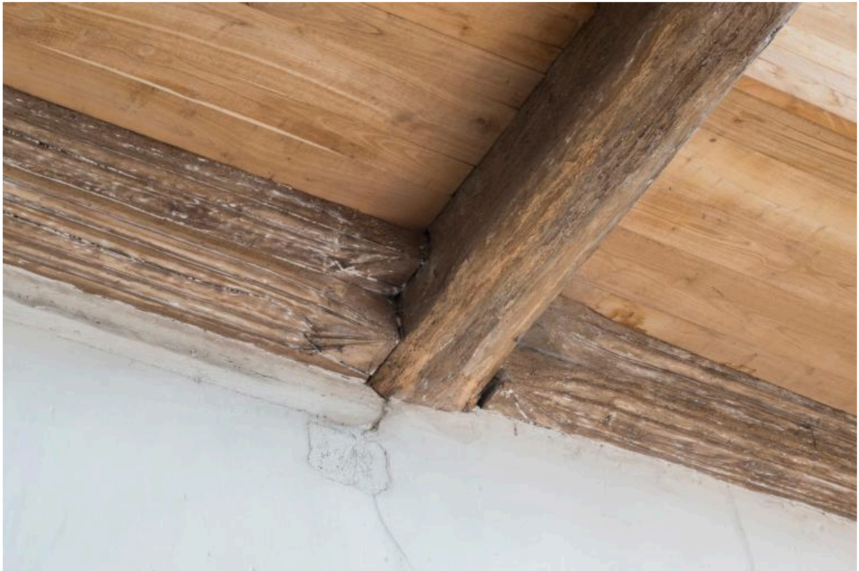
Détail de la sablière au-dessus des grandes arcades autour du premier entrait de la nef.
