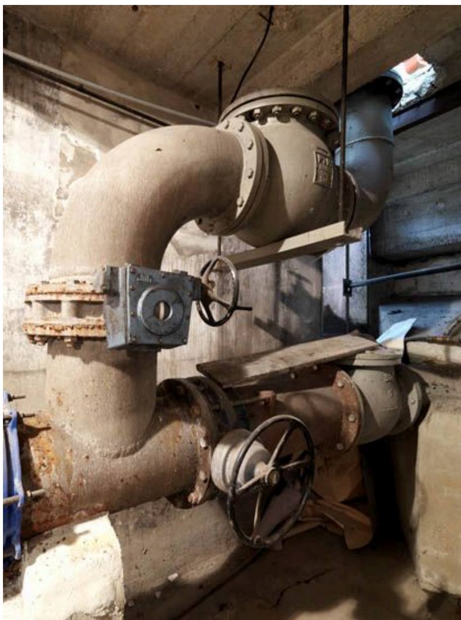
Anti-bélier en aval de la conduite de refoulement.
