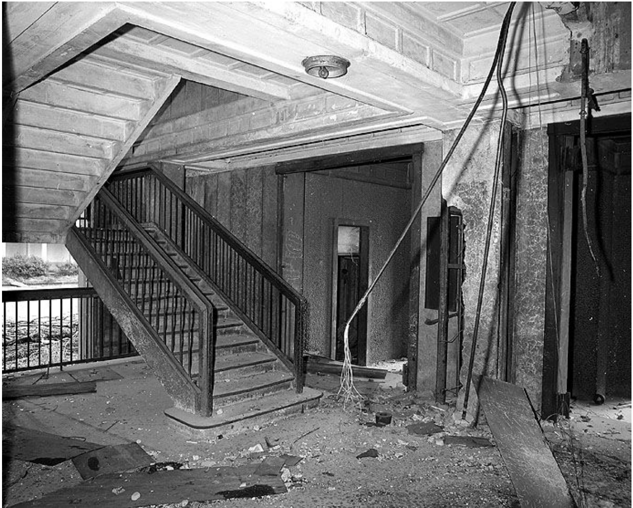
Tour 1, Cage d'escalier, Rez-de-chaussée. Campagne photographique, lors de la destruction du bâtiment en 1976.
